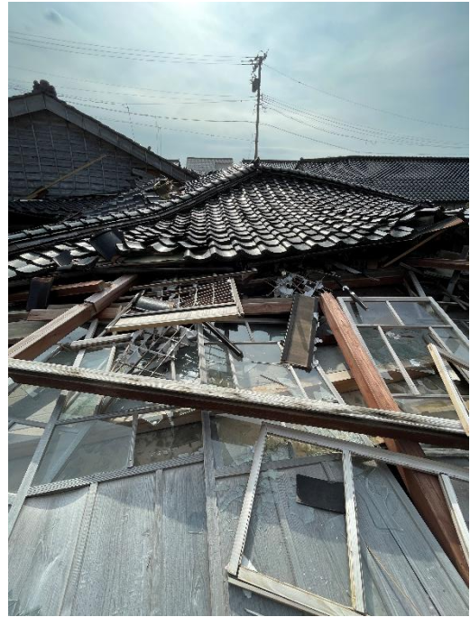
倒壊した国指定重要文化財 旧角海家住宅（輪島市、2024年2月14日）
